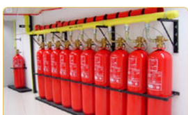
Bateria de cilindres de FE-13 de 67L
